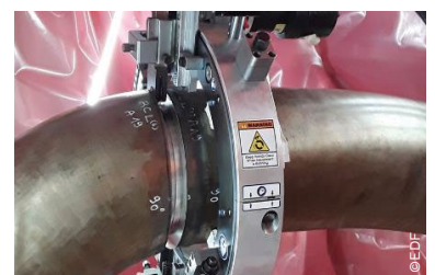
DIPDE, 6 chantiers de corrosion sous contrainte terminés au 1 er semestre 2023 (8 pour l'année 2022).
